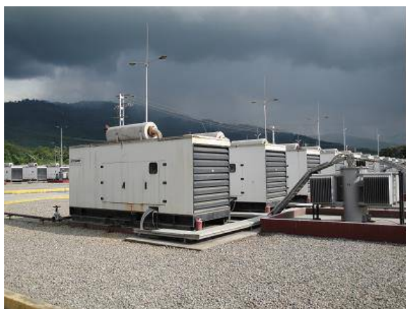
Foto 1: Grupos electrógenos Emplazamiento Monay
